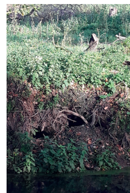
Dégâts que peuvent causer les ragondins.
